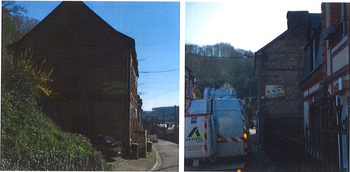
Publicités murales non conformes aux règles nationales car situées en site classé à Pavilly
